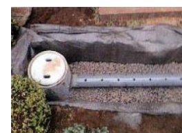
浸透トレンチ
