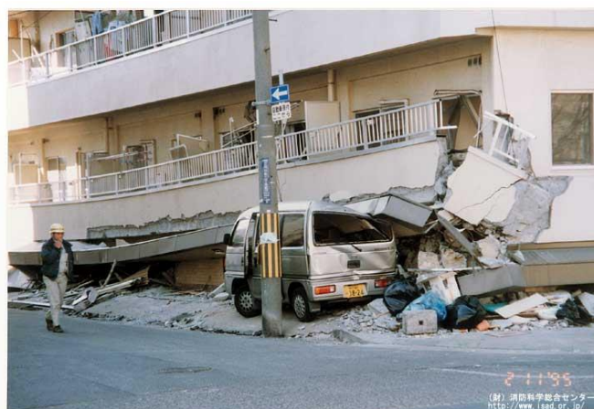
[マンションの倒壊]
