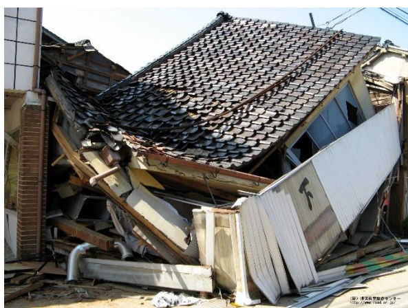
[木造住宅の倒壊]
