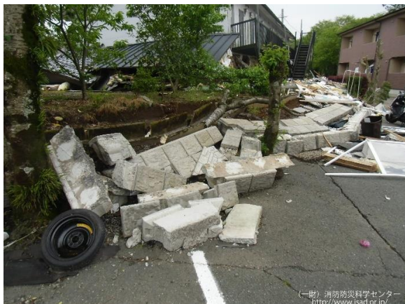
[ブロック塀の倒壊]
