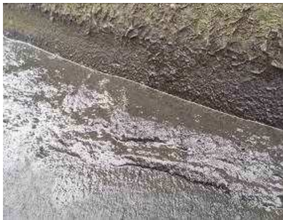
写真 2. 7 汚泥堆積状況（近景）
