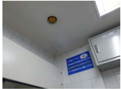
トイレ内にフラッシュライトを設置 (蒲田図書館)
