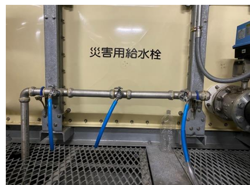
マンションにおける災害用給水栓の例
