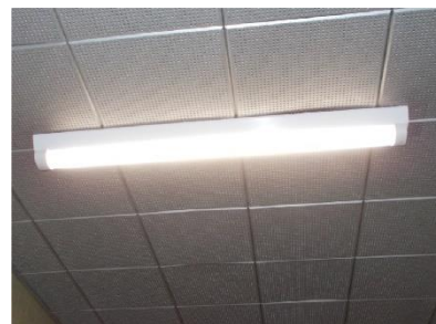
区営住宅共用部の LED 蛍光灯
