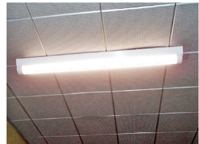
区営住宅共用部の LED 蛍光灯
