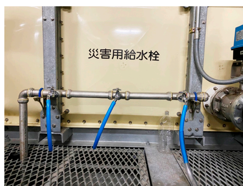
マンションにおける災害用給水栓の例
