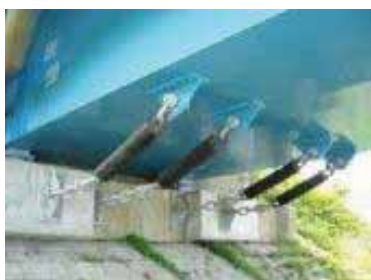
[落橋防止装置]
