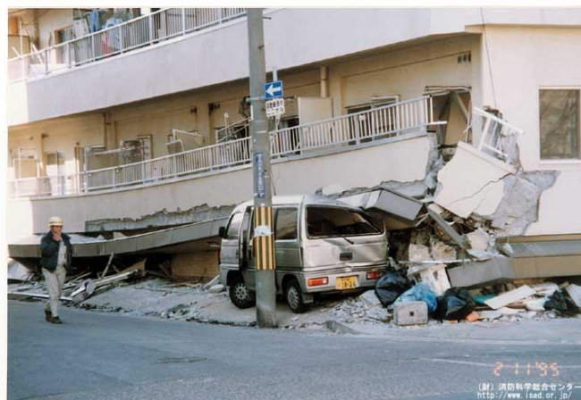
[マンションの倒壊]
