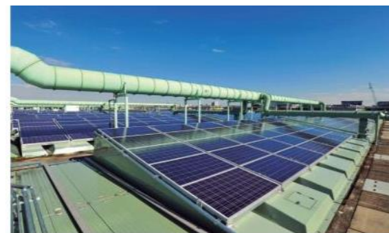
「太陽光発電設備」 森ヶ崎水再生センター
