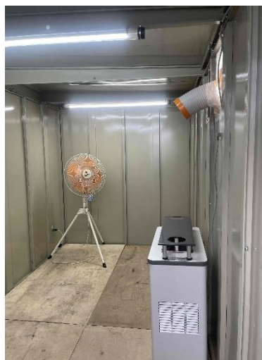
2 喫煙所内部写真 集塵機設置状況
