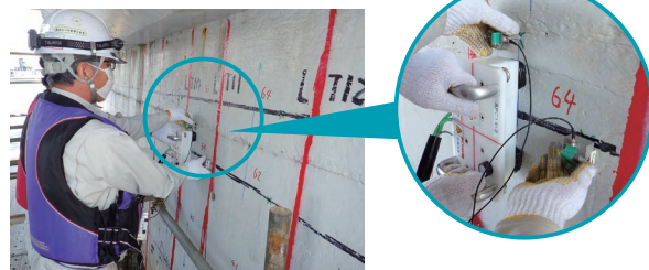
最新の非破壊検査である電磁パルス法により腐食を発見
