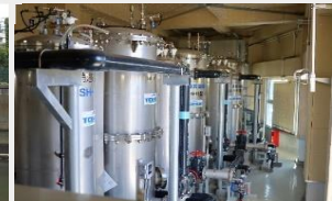
浄化施設建屋内
