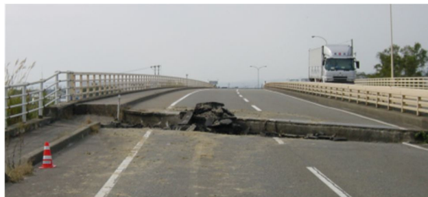
写真 6.2 橋梁取付部での段差発生事例
