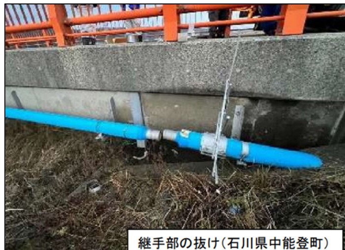
写真 6.1 能登半島地震における添架水道管被害事例
