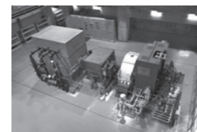
蒸気タービン発電機
