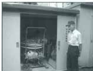
川端自治会の消防隊のポンプ格納庫も設置されています。
