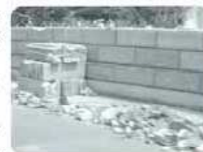
倒壊したブロック塀、25年前の宮城県沖地震ではこれで多くの子どもが犠牲になりました
