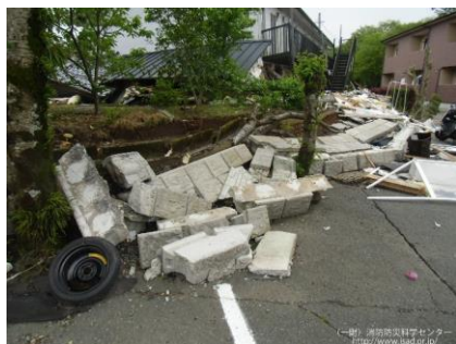
[ブロック塀の倒壊]
