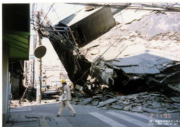
[建物倒壊による道路閉塞]
