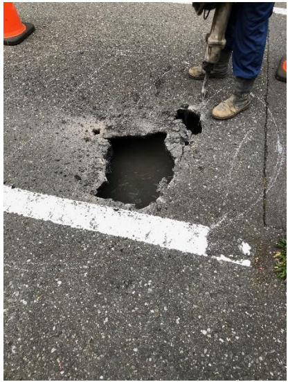
道路の穴・段差
