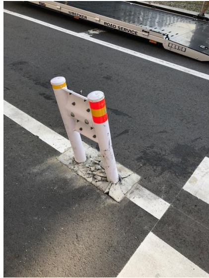
ガードレールの 損傷
