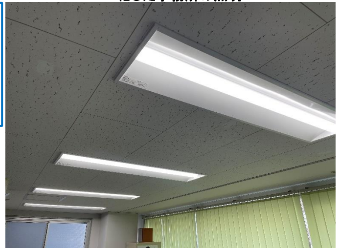
LED化した事務所の照明
